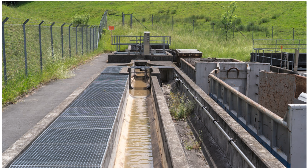
Hier kommt das Abwasser in der ARA Mühltoibel erstmals wieder an die Oberfläche. Fotos: nek
