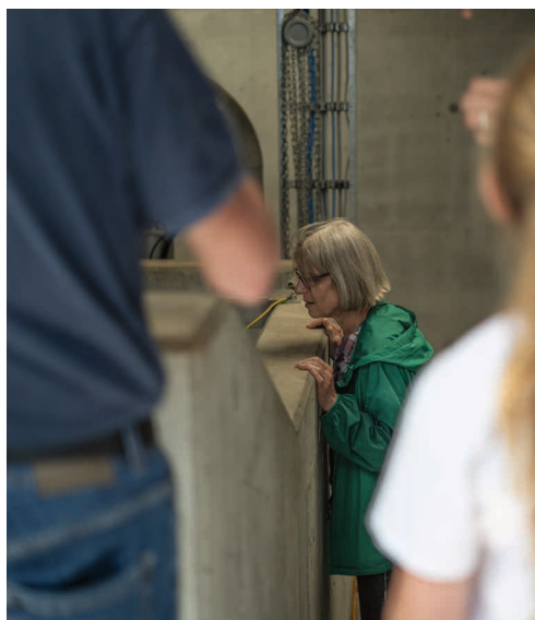
Streng für die Nase: Blick ins Pumpwerk Blatten.
