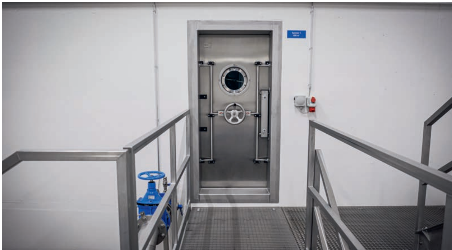
Hinter dieser massiven Stahltür befinden sich 1,6 Mio. Liter Trinkwasser. Öffnen kann man sie nur, wenn das Wasser abgelassen wurde.
