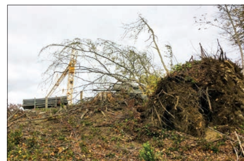
Rechts: Unterhalb der Baustelle des neuen Reservoirs Schwendi wurden mehrere kräftige Buchen umgeworfen. Foto: Sepp Zurmühle
