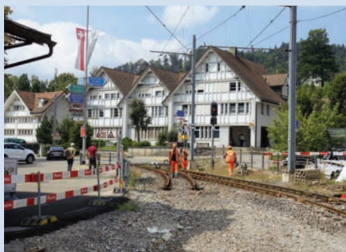
Die alten Gleise im Bahnhof werden zurück- und eine neue Weiche wird eingebaut.
