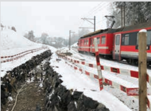
In den nächsten Monaten wird hier das zweite Gleis für die Doppelspur zwischen Lustmühle und Sonnenrank eingezogen.
