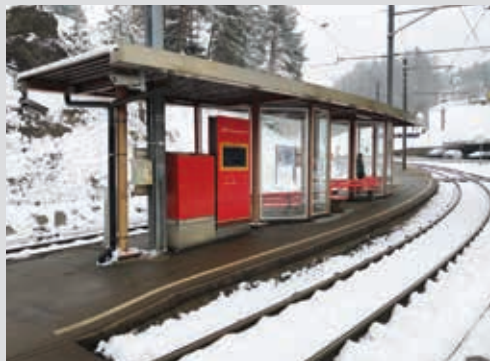
Die Haltestelle Lustmühle wird totalsaniert und behindertengerecht gebaut; die Arbeiten sollen bis zur Betriebsaufnahme der Modernisierung abgeschlossen sein.
