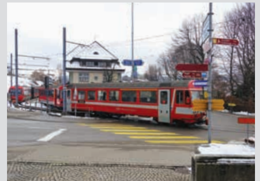
Der Bau des Bahnhofkreisels verzögert sich wegen Einsparungen; er wird bei Beginn der Bauphase mit einer Lichtsignalanlage ausgestattet. Der Bau erfolgt unter Vollbetrieb der Bahn. Baustart ist je nach Verlauf der Einspracheverhandlungen frühestens diesen Sommer.
