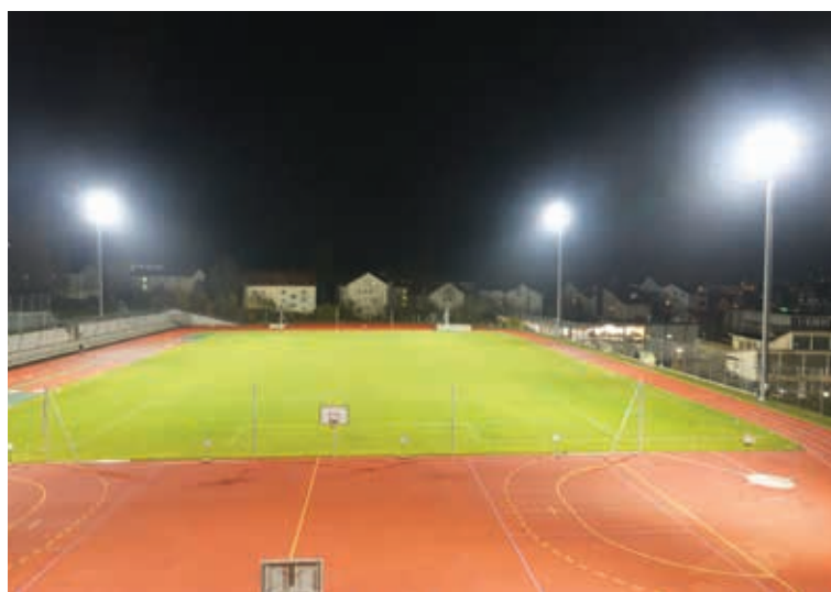
Erste Tests der neuen LED-Beleuchtung zeigen: Die Ausleuchtung ist gleichmässig.
