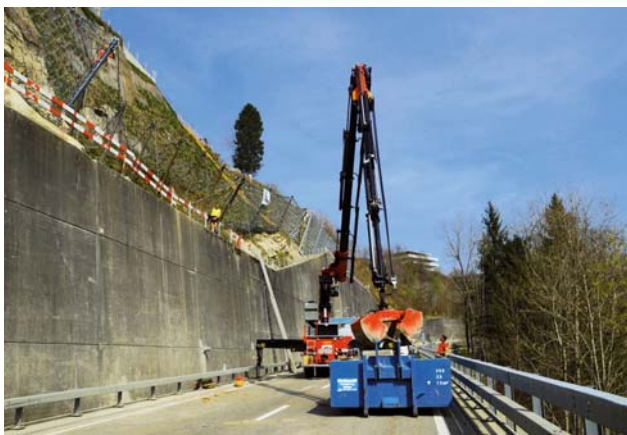
Die Betonwüste als Energielieferantin. Das Bild entstand anlässlich der Sanierungsarbeiten nach den Unwetterschäden 2012.
