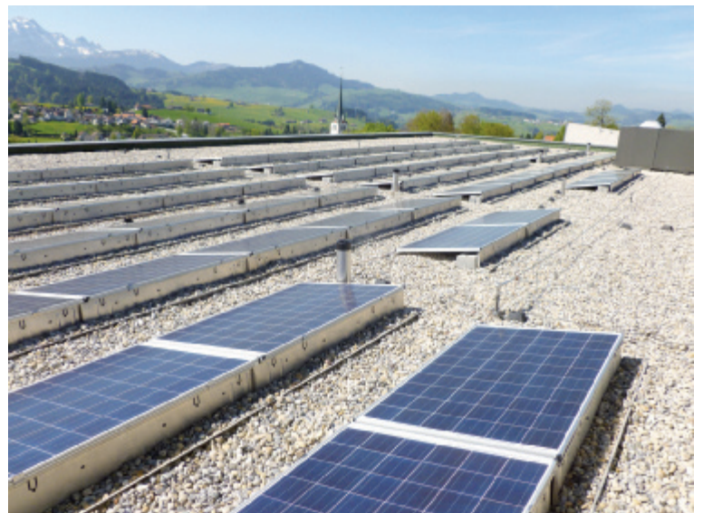
Energie direkt vom Hausdach für das Haus Unteres Gremm. Foto: Paul Egger
