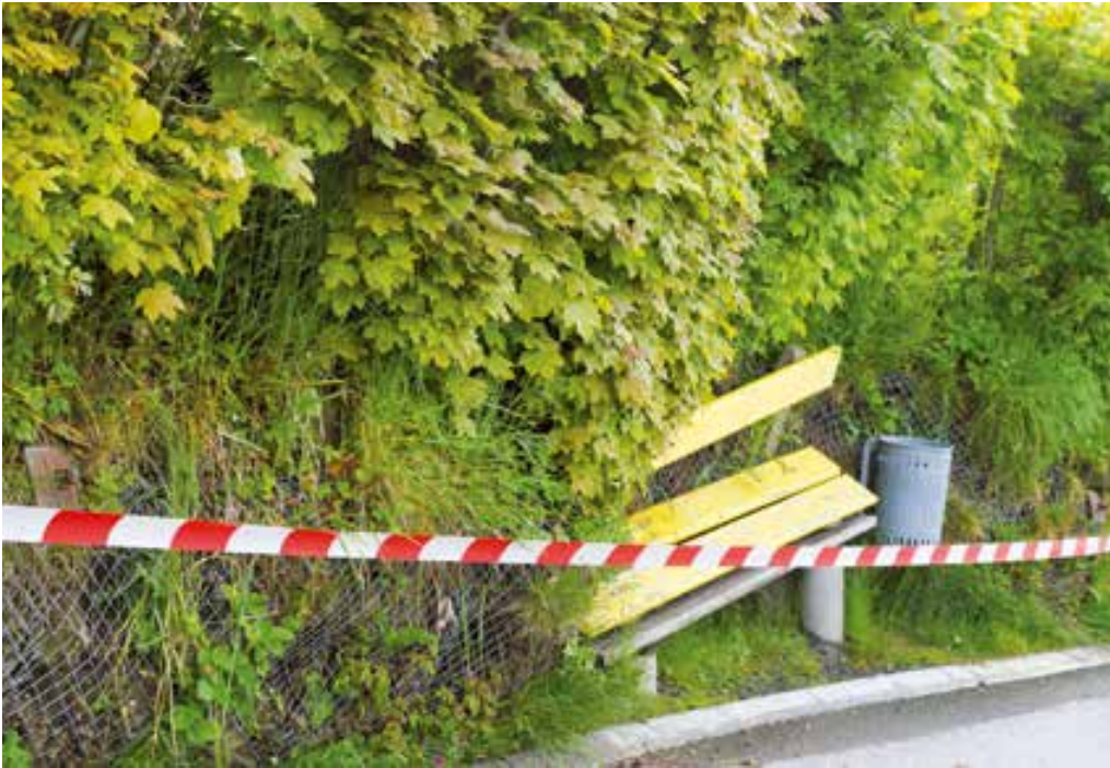
Der Hang oberhalb der Bündtstrasse kam nach den Regenfällen ins Rutschen und muss nun saniert werden.
