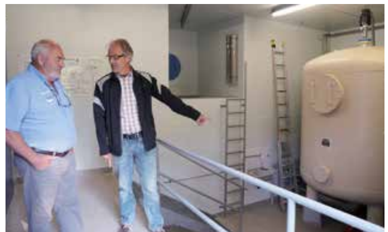
Der Leiter der Wasserversorgung Teufen, Bruno Mösli (links) und der beratende Ingenieur Jürg Meier im Innern der Aufbereitungsanlage. Fotos: EG
