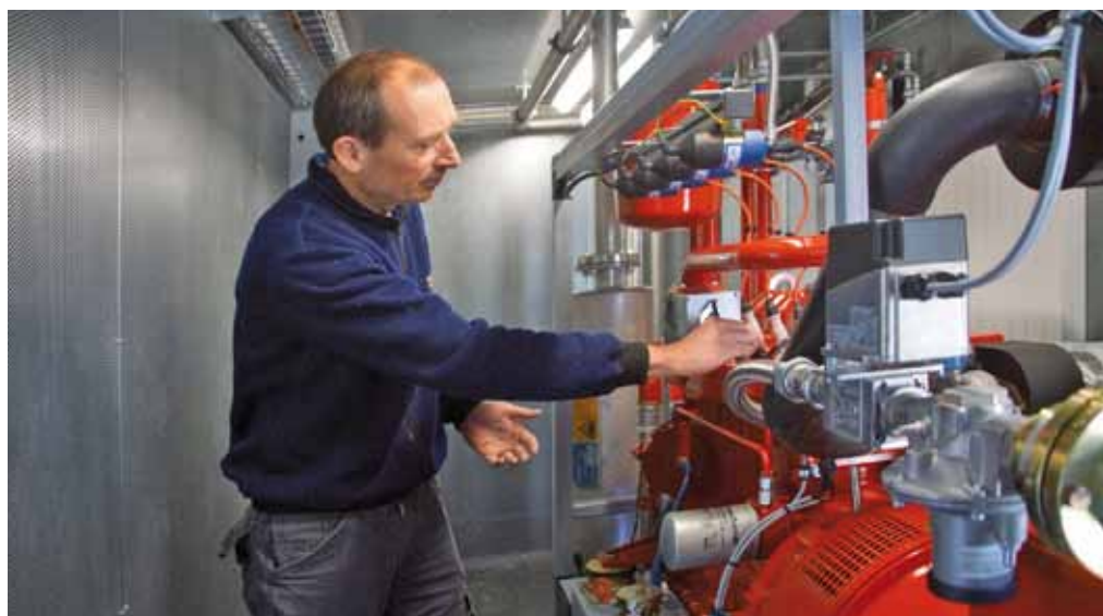
ARA-Betriebsleiter Michael Stern präsentiert das neue Blockheizkraftwerk der ARA Teufen. Hier produziert die ARA mit Biogas aus dem Faultrum 80 Prozent des Eigenbedarfs an Strom. Foto: EG
