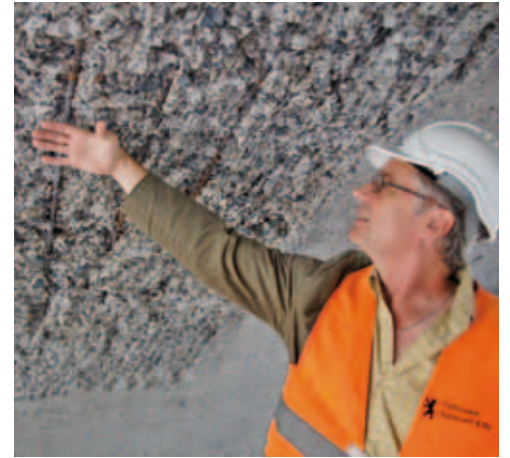
Daniel Sonderer zeigt die schadhafte Stellen des Spritzbetons.
