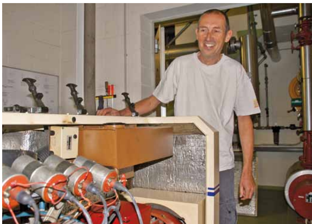
Das in die Jahre gekommene Blockheizkraftwerk im Untergeschoss der ARA wird ersetzt.
