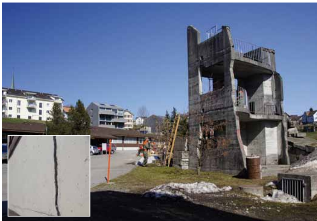
Der Brandbekämpfungsturm ist sichtlich in Schiefelage geraten. Kleines Bild: Risse in der Fassade deuten auf den instabilen Untergrund hin.
