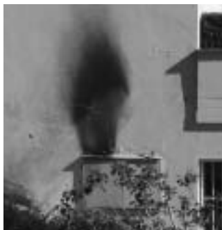
Ein Molotowcocktail beschädigte die Fassade der Villa Scarpatetti an der Schützenbergstrasse.
