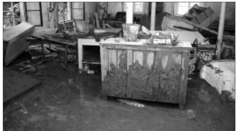
Einer der zahlreichen überfluteten Keller.
