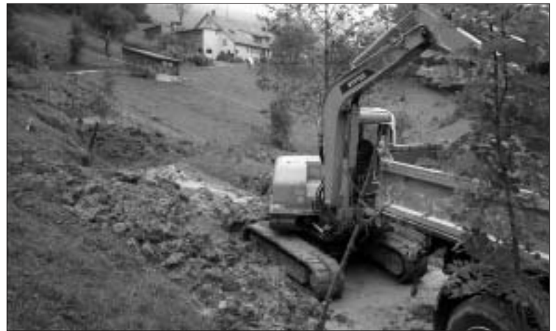
Die Zufahrt zum Löchli wurde meterhoch verschüttet.
