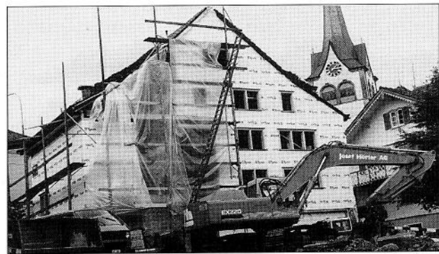
Der Anbau südlich des «Bahöfli» ist bereits abgerissen. Als nächstes werden die Fassade und der Klinik-Neubau erstellt. Fotos: GL
